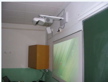
Instalación proyector Epson 450Wi
